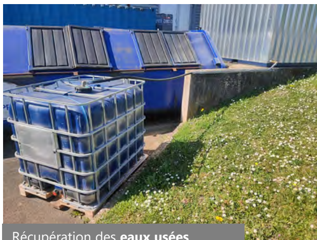
Récupération des eaux usées
