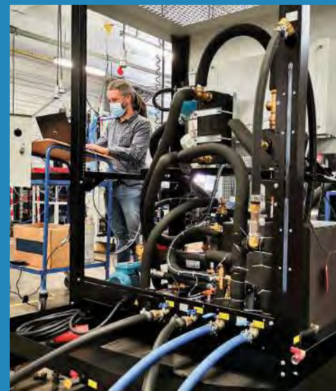
SKID150 en phase d'essais.
