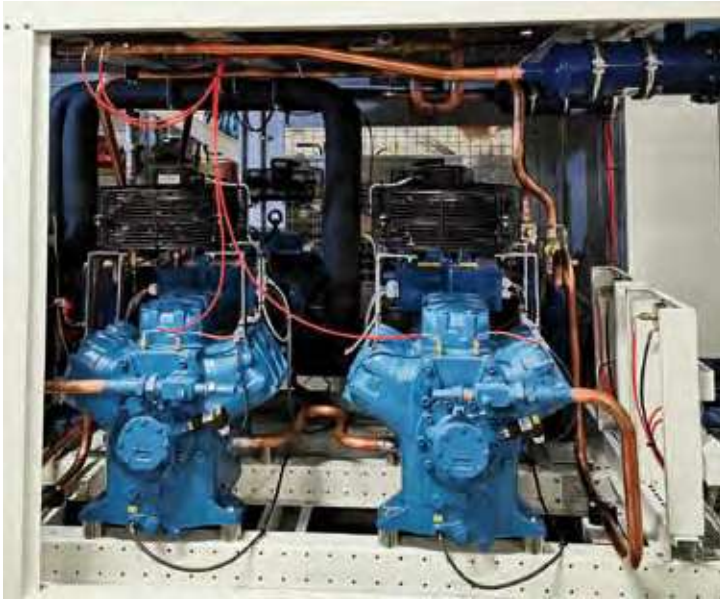
Refroidisseur d'eau glycolée -10°C et 100% redondant pour l'industrie cosmétique.
